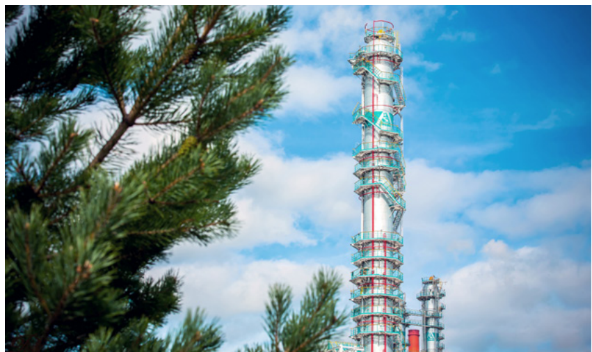
Газофракционирующая установка в Тобольске
