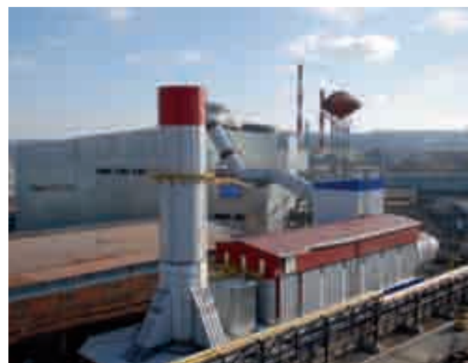
Газоочистка электросталеплавильной печи СТЗ
