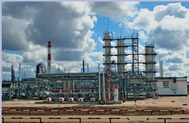
Установка изомеризации на Нижегородском НПЗ
