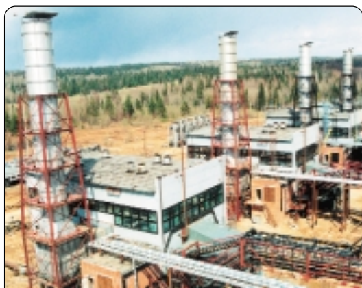
На КС ООО «Пермтрансгаз»
