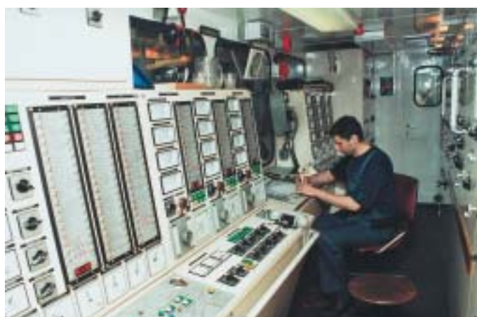
Речные лайнеры компании оснащены современным оборудованием
