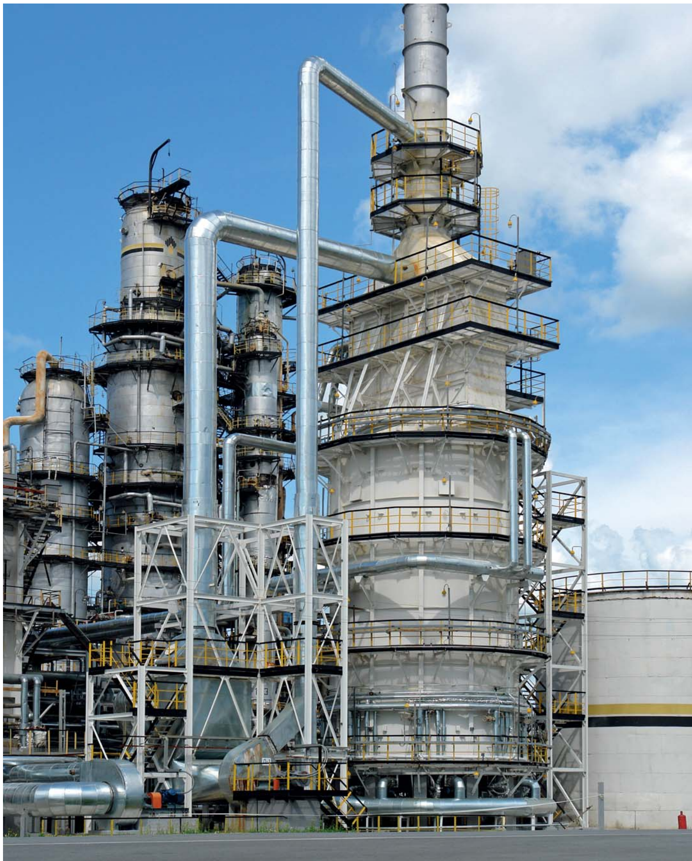
Установка гидроочистки на Ачинском НПЗ
