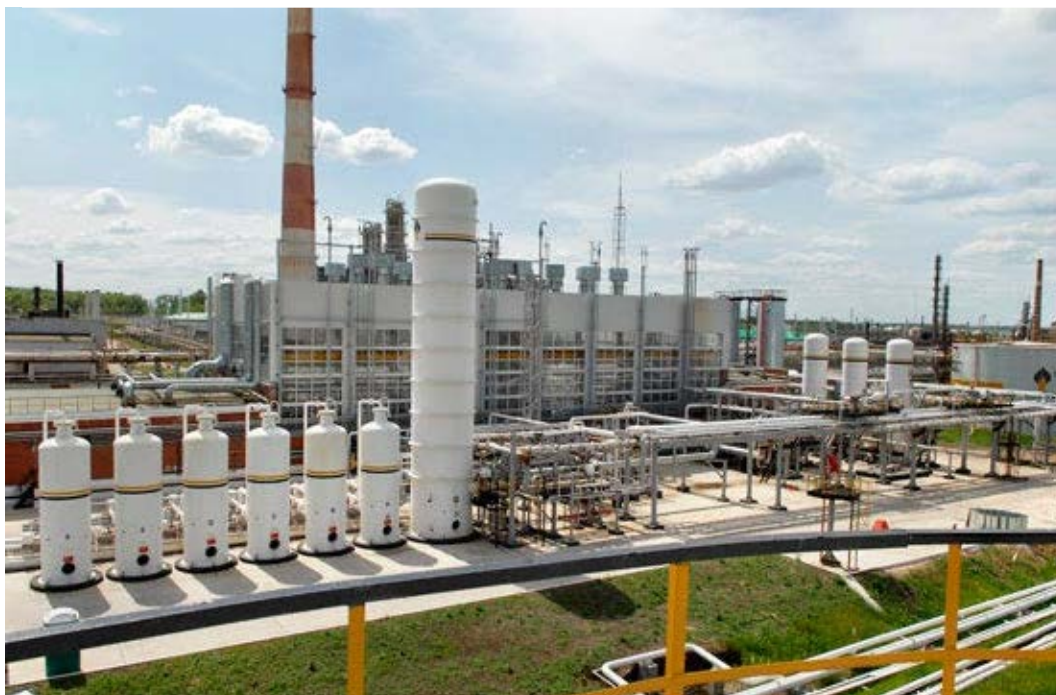
Опытно-промышленная установка процесса GTL на Новокуйбышевском НПЗ
