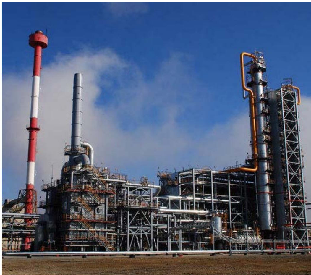
Блок предварительного фракционирования прямогонного бензина установки каталитического риформинга Комсомольского НПЗ
