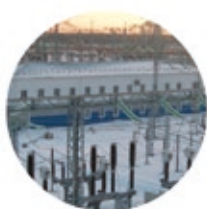
Энергетическое кольцо 330 кВ в Санкт-Петербурге
