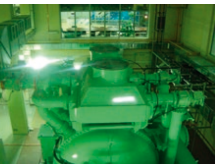
Элегазовый трансформатор 220/20 ПС «Сколково»
