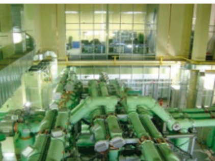
КРУЭ 220 кВ ПС «Сколково»
