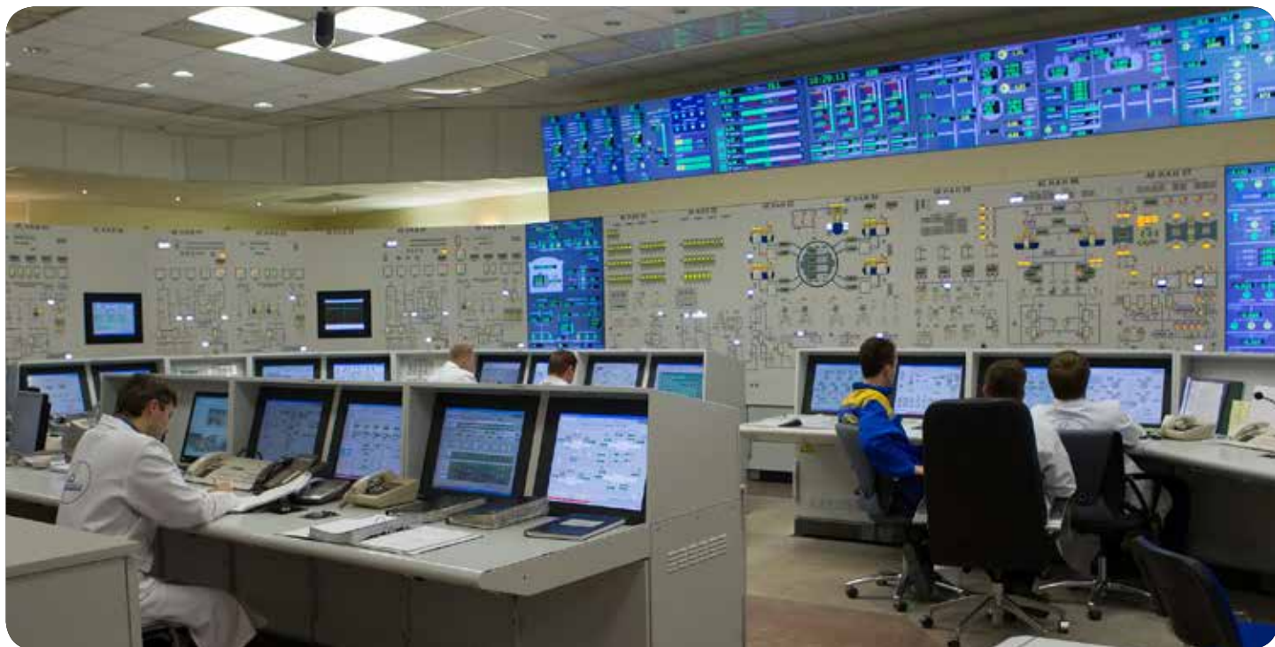
Блок щитового управления на АЭС
