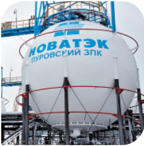
^ Резервуары для хранения СУГ на Пуровском ЗПК
