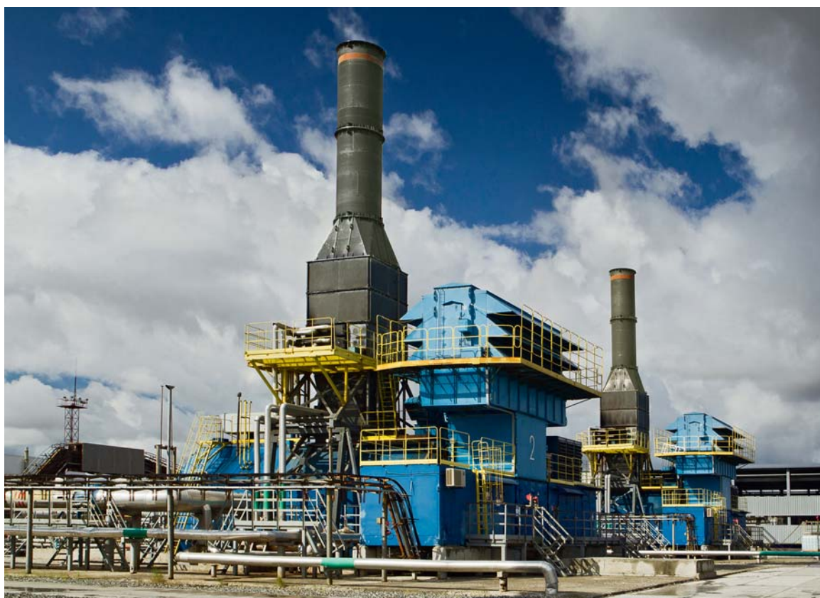
Дожимная компрессорная станция Восточно-Таркосалинского месторождения
